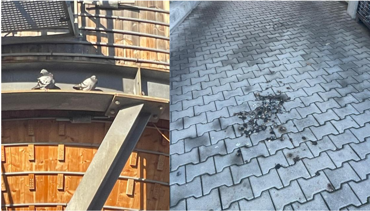
Abb. 12: Taubenruheplätze mit Verkotung der Umgebung, keine Nester auf dem Betriebsgelände, Quelle: Kraus, 2025
