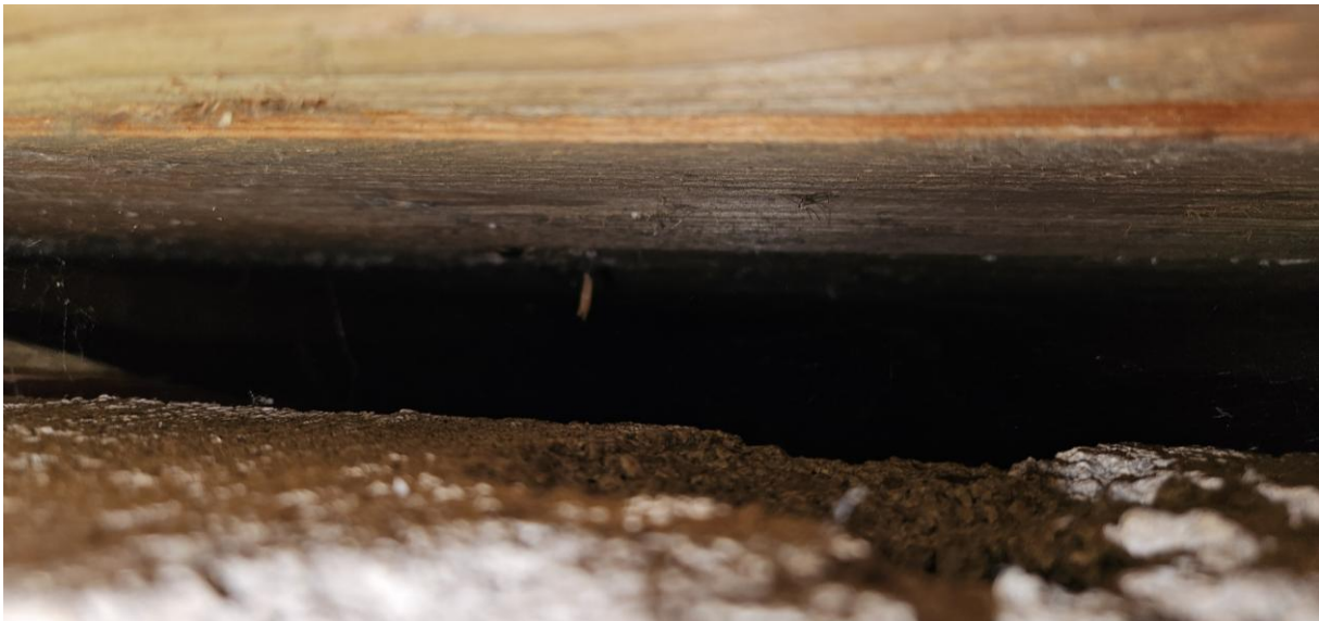
Abb. 8: Spalten zwischen Mauerwerk und Dachschalung (oben), Aufnahme Kontrolle Spalten (unten), Quelle: Kraus, 2024
