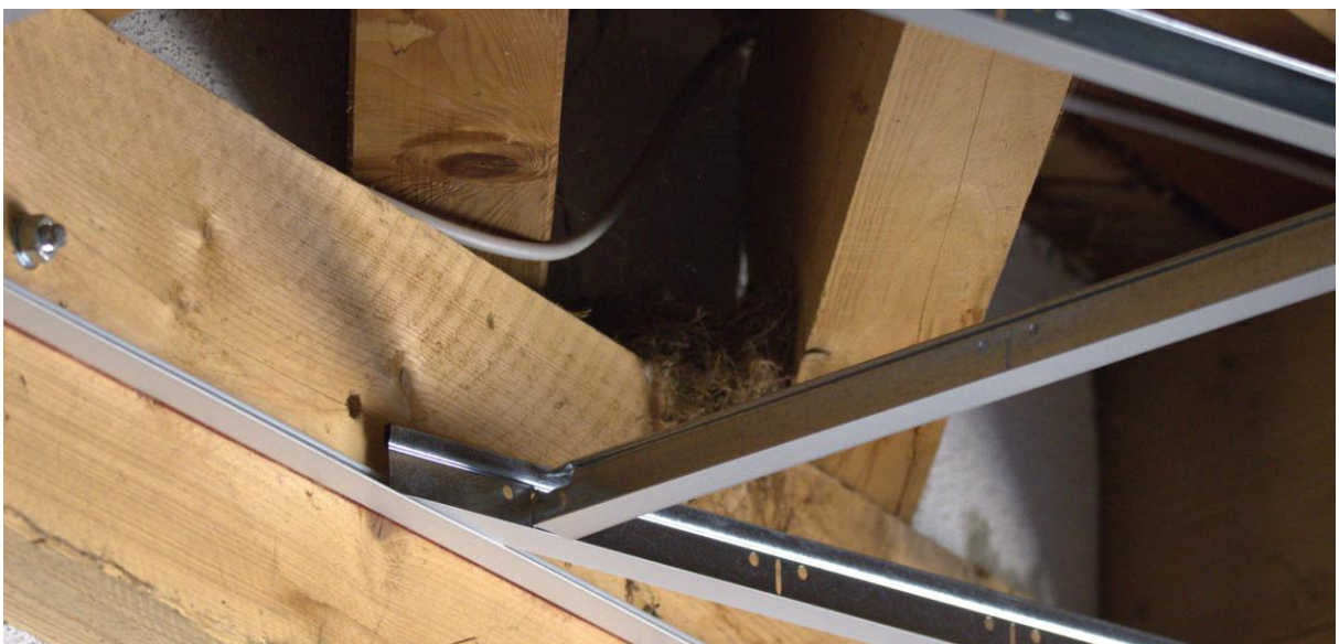
Abb. 9: Vordach mit Nestbau, Quelle: Kraus, 2024
