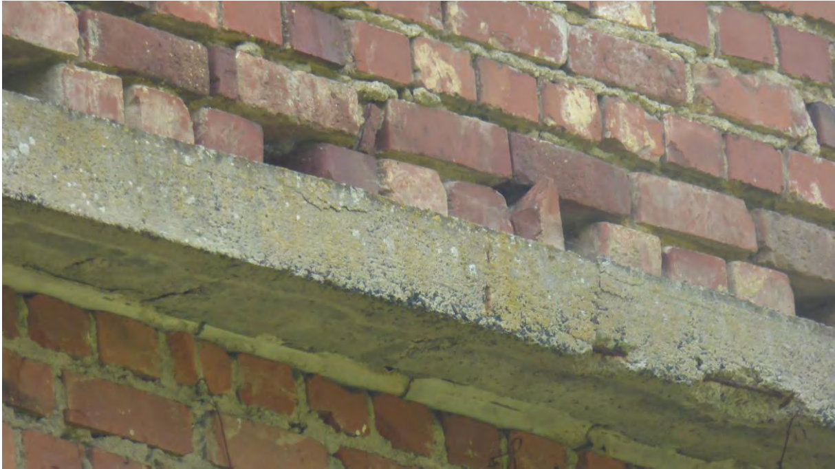
Abbildung 15: Fassadennischen mit Habitatpotential, Kraus 2022
